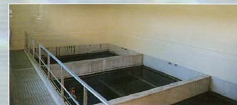
Salle des filtres à charbon actif en grain.
