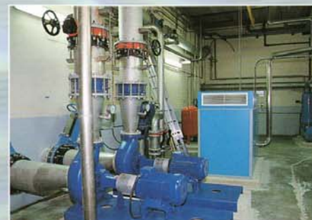
Salle des pompes.
