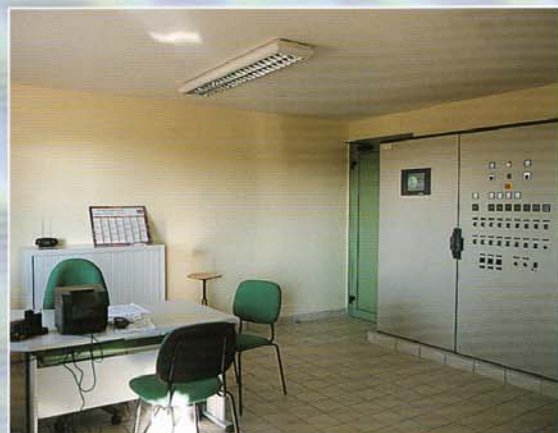
Salle de commande.
